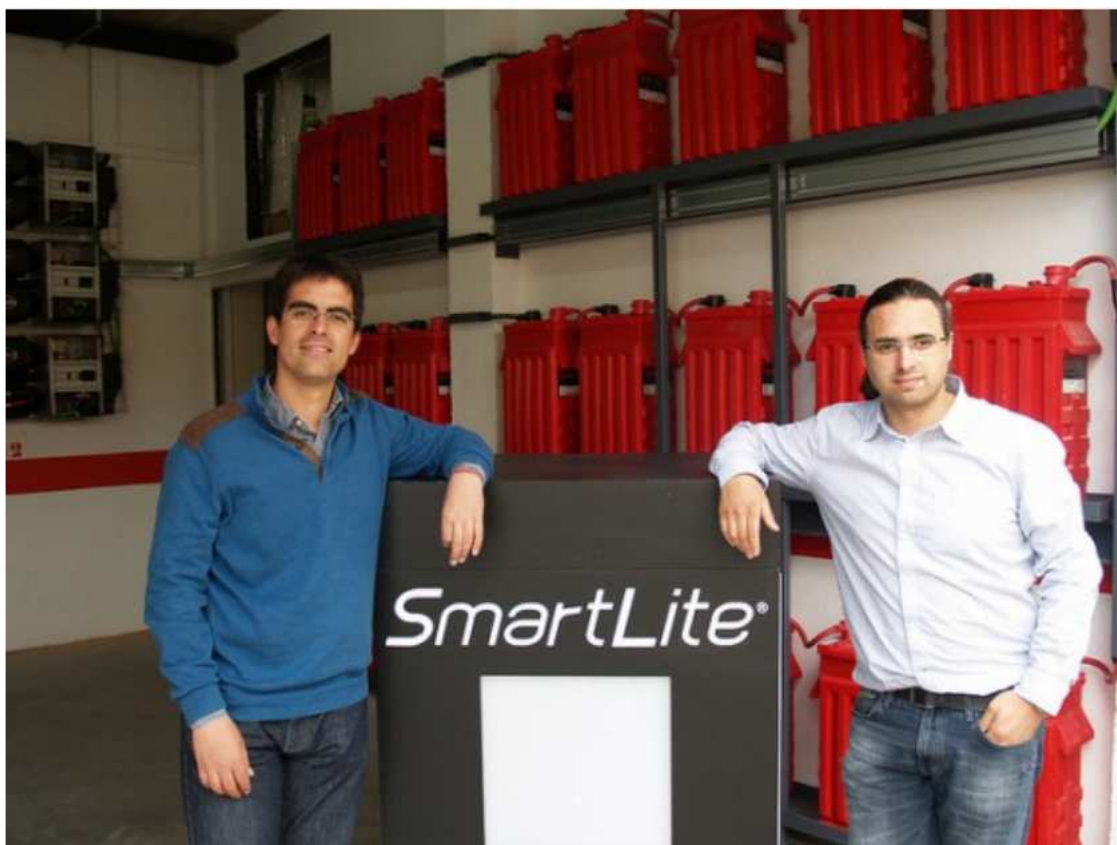
D'esquerra a dreta: Jordi Rabat i Francesc Comino, impulsors d'Espai Zero, davant de les bateries elèctriques que condensen l'energia produïda per diferents fonts renovables. Foto: Monmar Comunicació.
