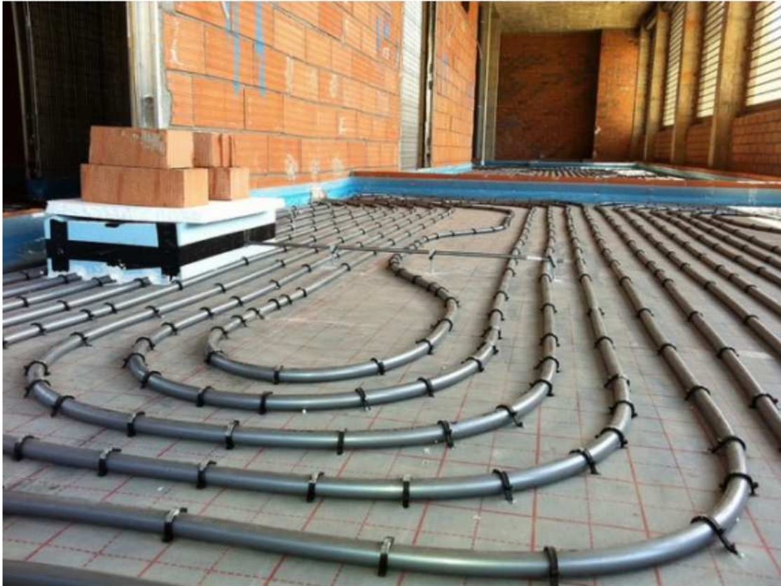
Un terra radiant permet la climatització del local amb un cost energètic molt inferior al d'un sistema d'aire o de radiadors convencionals. Foto: Wattia Innova.
